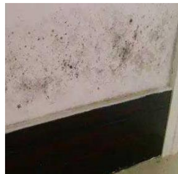
断熱性の悪い内装による結露
