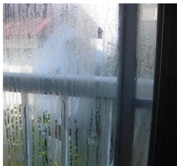
<施工前> 朝方 結露がひどい
